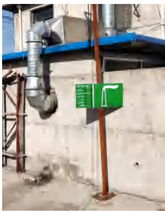
废气处理设施及排气筒
