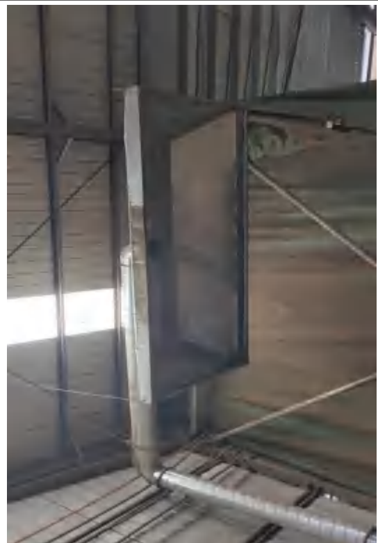
废气收集设施
