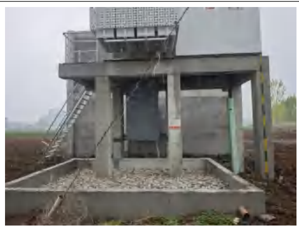
风机变压器贮油坑
