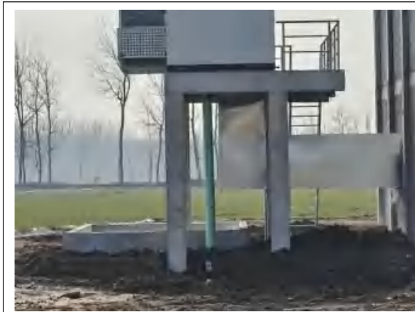
风机变压器贮油坑
