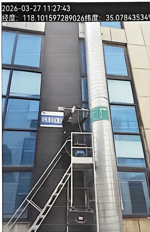
DA001 废气排气筒
