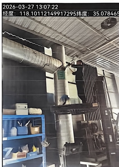
DA002 废气排气筒
